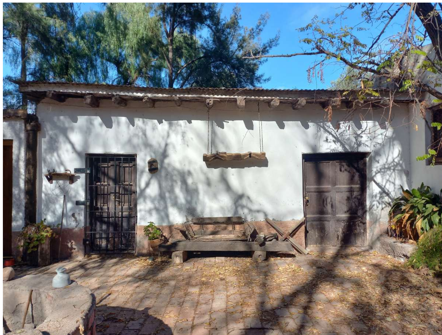
Vista frontal de vivienda: puerta de lado derecho pertenece al ingreso de la cocina, puerta de rejas del lado izquierdo pertenece al ingreso del baño original. Fuente: arq. Paula Martedi.
